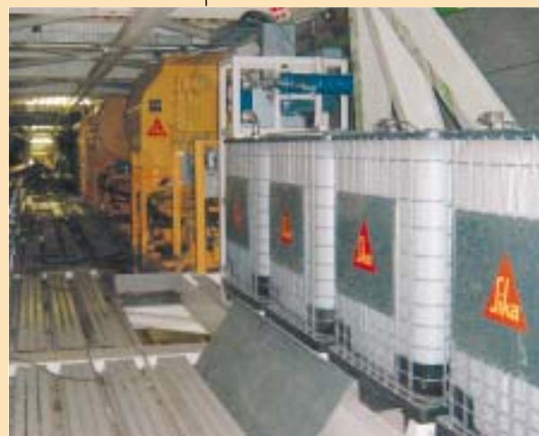
Betontransferstation und Zusatzmitteltanks
